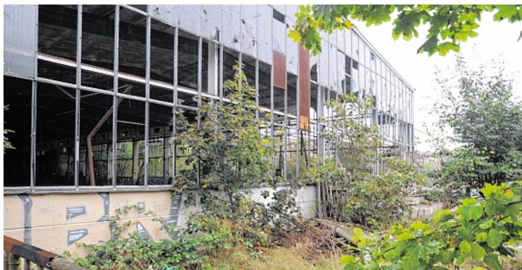
Verwahrlost und vom Vandalismus gezeichnet: Das Areal der ehemaligen Möbelwerke an der Wismarschen Straße stellt derzeit eine Gefahrenquelle dar. FOTO: REINHARD KLAWITTER
